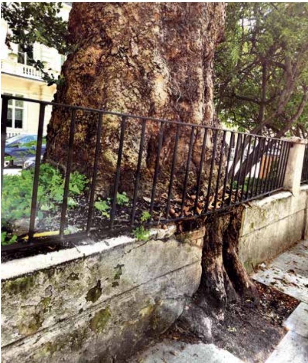
Arbre ayant brisé un muret qui a tout de même été conservé
